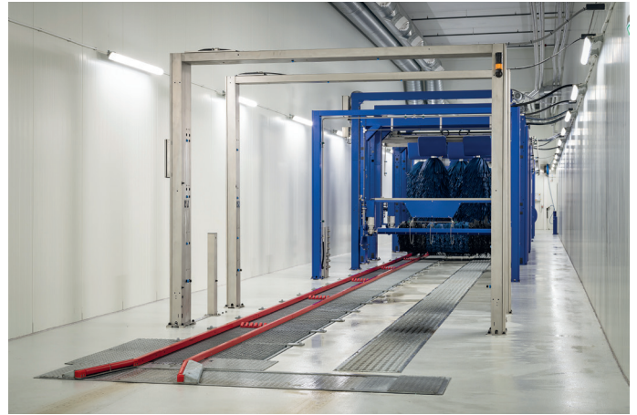
80 prosent av vannet i den 35 meter lange vaskehallen gjenvinnes.
